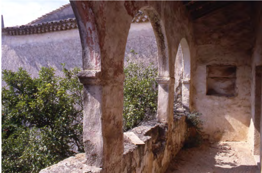
Loggiato, del primo piano, del convento di Santa Maria del Palazzo. Foto degli anni '80 del XX secolo.
